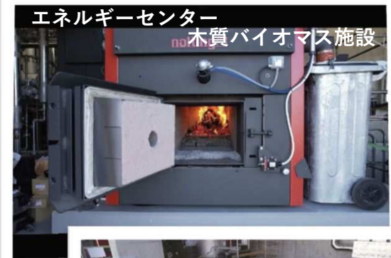
エネルギーセンター解説板
